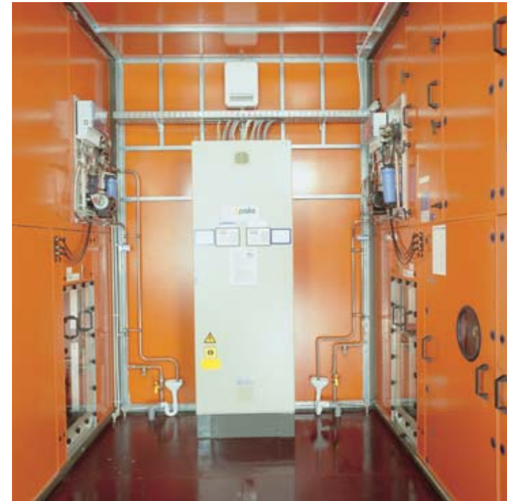
Парораспределительная система в канале
